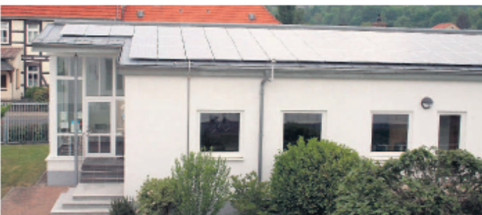
Eines der sieben Dächer auf dem VHM-Betriebsgelände, auf dem die neue PV-Anlage installiert ist
