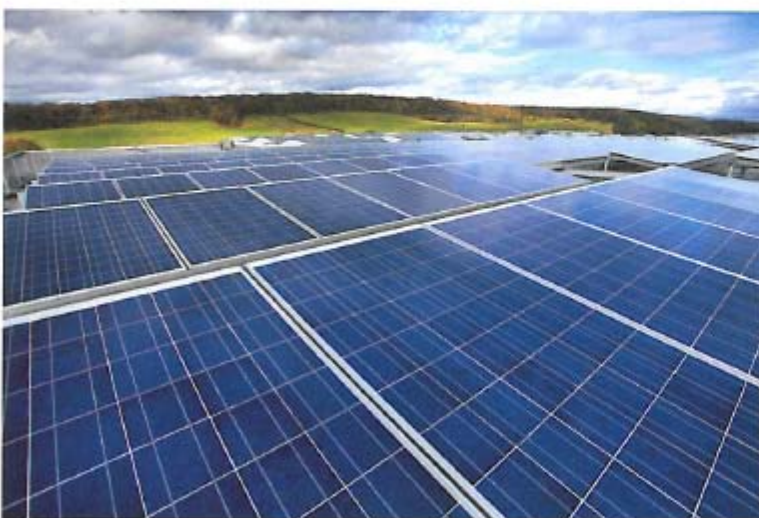
Bild 1. Flachdächer bieten reichlich Raum zur PV-Installation – wenn da nicht die meist geringe Belastbarkeit wäre (Foto: Fotolia)
