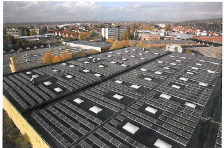
Bild 6. PV-Installation in besonderer Größenordnung: Die Solaranlage auf dem Dach von Resopal (Fotos 5, 6: ANTARIS SOLAR)
